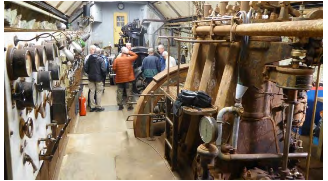
Fästningens elcentral för reservkraft
